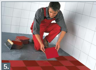
5. Auftragen des Fliesenklebers und Verlegung der Fliesen. Um die beste Wärmeleitung zu erreichen, sollten die Fliesen möglichst vollflächig, ohne Lufteinschlüsse verklebt werden.
